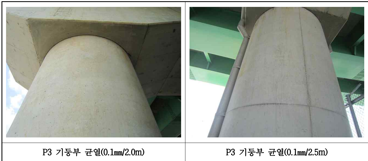
【사진 3.12】교각 손상현황
